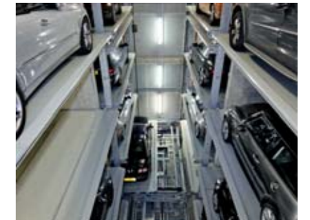
12 Nach dem Erreichen des vorgesehenen Lagerfachs wird die belegte Parkpalette bei der dreireihigen Anordnung mit der dahinterliegenden Parkpalette gekoppelt und vom Shuttle in das Lagerfach geschoben.
