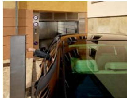
01 Am Bedientableau außen vor der Einfahrt fordert der Fahrer den Autoaufzug mit seinem Transponder an. Gleichzeitig wird dem automatischen Parksystem die Anwahl kommuniziert und die Anlage für Ausparkvorgänge gesperrt, um Begegnungsverkehr zu vermeiden.
